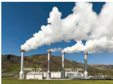
شکل ۱۱-۶- نیروگاه زمین گرمایی مشکین شهر- اردبیل
