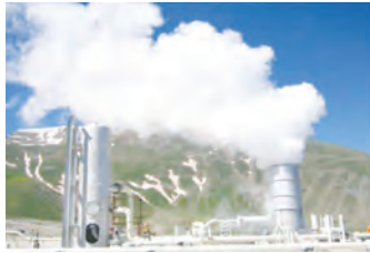
شکل ۱۲- نیروگاه زمین گرمایی مشکین شهر که با توان تولیدی ۱۰۰ مگاوات نصب شده است.
