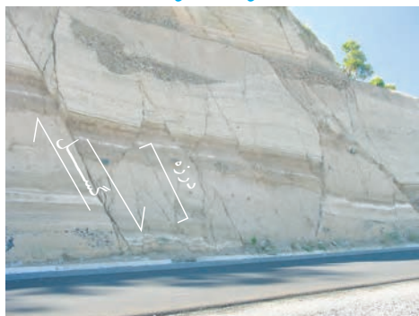
شکل ۱۵- مقایسه درزه و گسل (آذربایجان شرقی)
