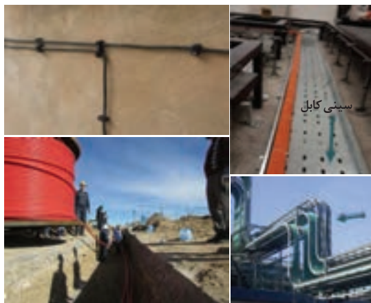
شکل ۱۹- انواع کابل کشی
