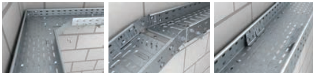
شکل ۴۴- اتصالات سینی کابل
