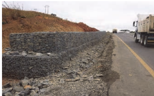
شکل ۱۰- دیوارهای گابیونی کنار راه
