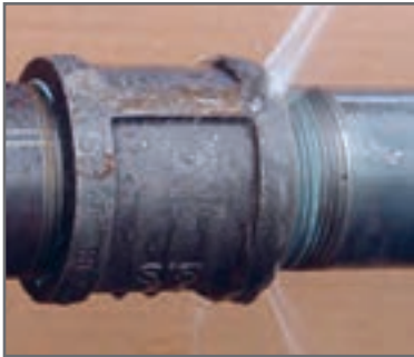
شکل ۱۱- یک اتصال در حال نشتی
