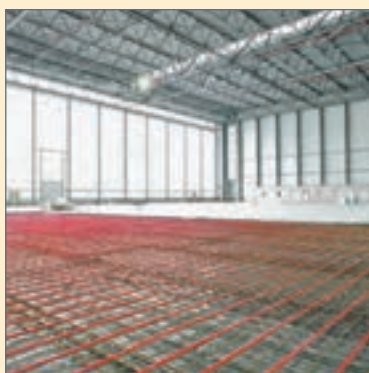
کارخانه‌ها و سوله‌های صنعتی
