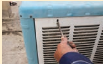
تنظیم آب پخش کن
