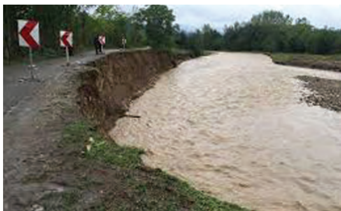
شکل ۴- وقوع سیل که باعث تخریب راه شده است.
