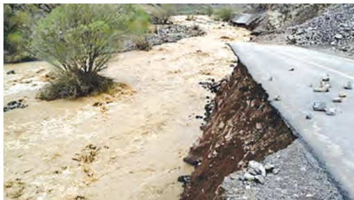
شکل ۱۹- تخریب بخشی از جاده چالوس در اثر طغیان رود
