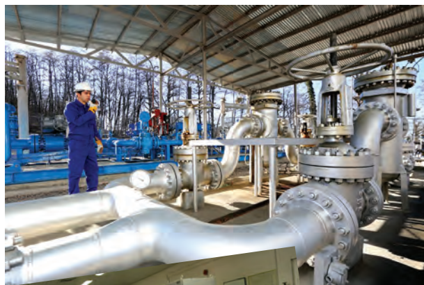
منطقه شمال - ایستگاه فشارشکن لاجیم
