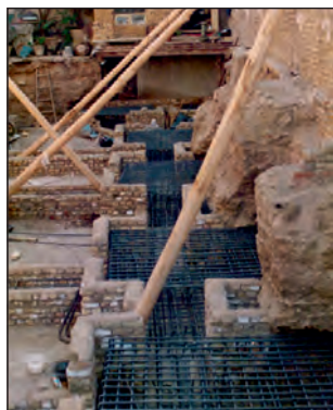
شکل ۱-۹۰ مهاربندی با شمع چوبی
