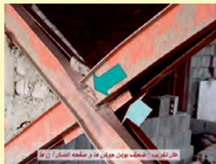
ضعیف بودن جوش و عدم اتصال مناسب
