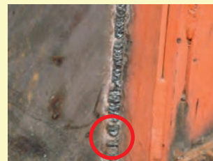
عدم جوش پیوسته - لوچه
