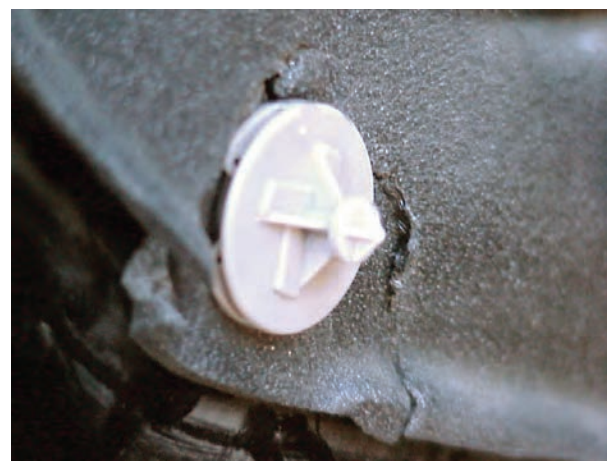
شکل ۲-۳۴- آسیب دیدن محل نصب خار در روی رودری
