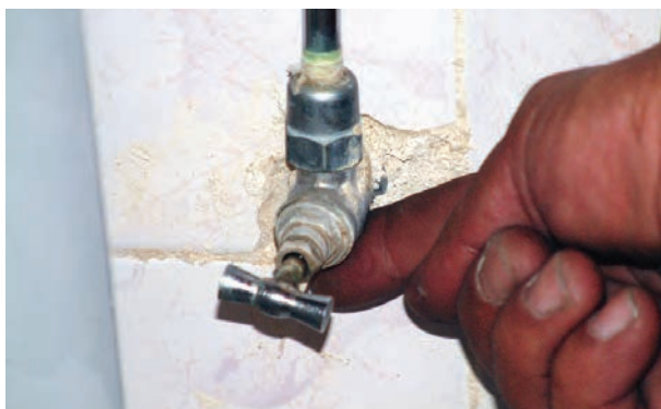
شکل ۱۴۷-۲- کنترل نشت آب از محل اتصال
