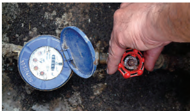
شکل ۱۹۷-۲- بستن شیرفلکه‌ی اصلی
