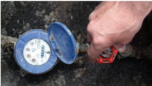
شکل ۲-۱۸۱- بستن شیرفلکه‌ی اصلی
