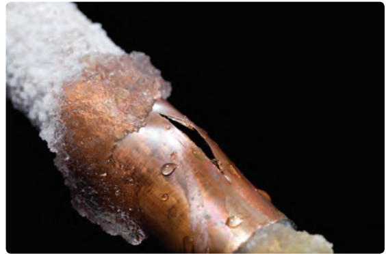
شکل ۶- شکستن لوله آب در اثر انجماد آب
