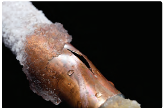
شکل ۶- شکستن لوله آب در اثر انجماد آب
