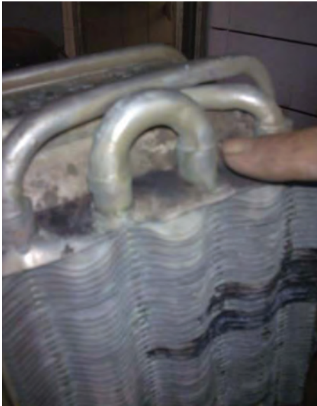
شکل ۱۱- تشکیل رسوب در آب‌گرم‌کن
