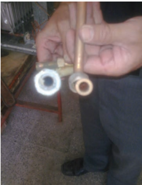
شکل ۱۲- تشکیل رسوب در لوله آب‌گرم
