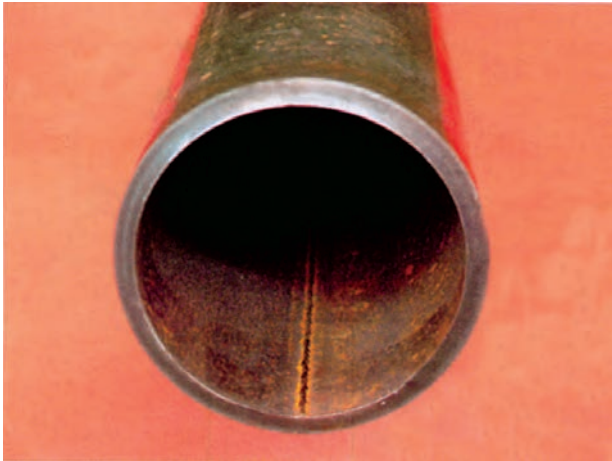
شکل ۲-۱۳- لوله‌ی برقو خورده
