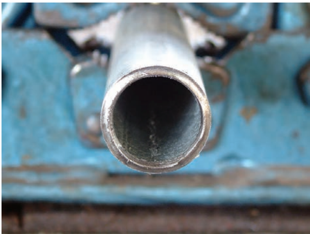
شکل ۲۰-۲- لوله‌ی برقو خورده
