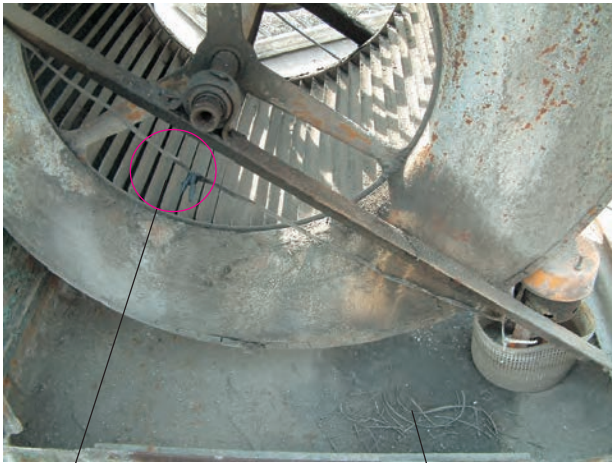
ترمیم نادرست سیم رابط
