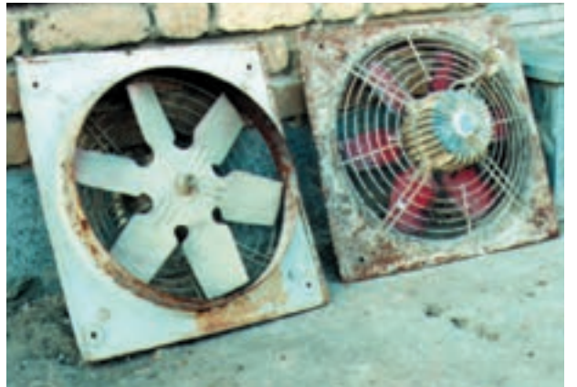
تعویض هواکشهای خراب و فرسوده
