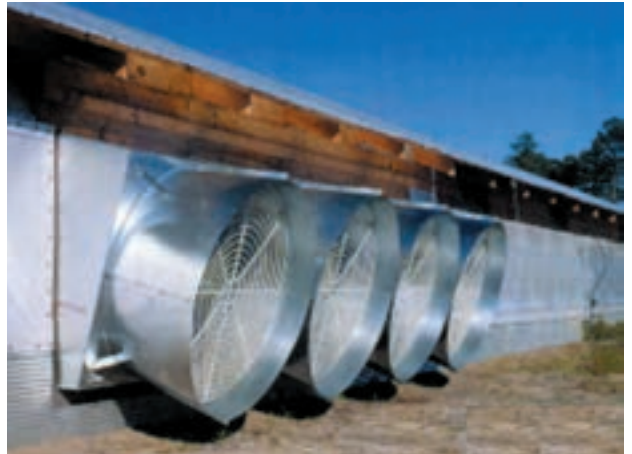
نمای هواکشها از بیرون جایگاه
