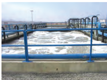
▲ شکل ۸-۲ تصفیه خانه آب
