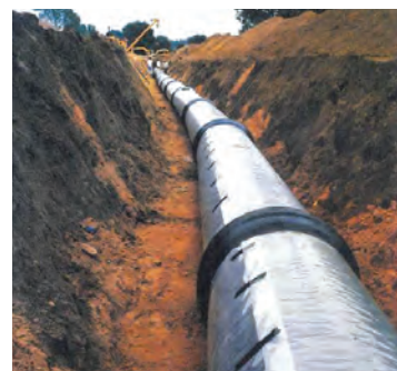
▲ شکل ۲-۲۱ لوله کشی انتقال آب شهری
