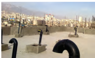
شکل ۲-۵۳ لوله‌های هواکش روی پشت‌بام
