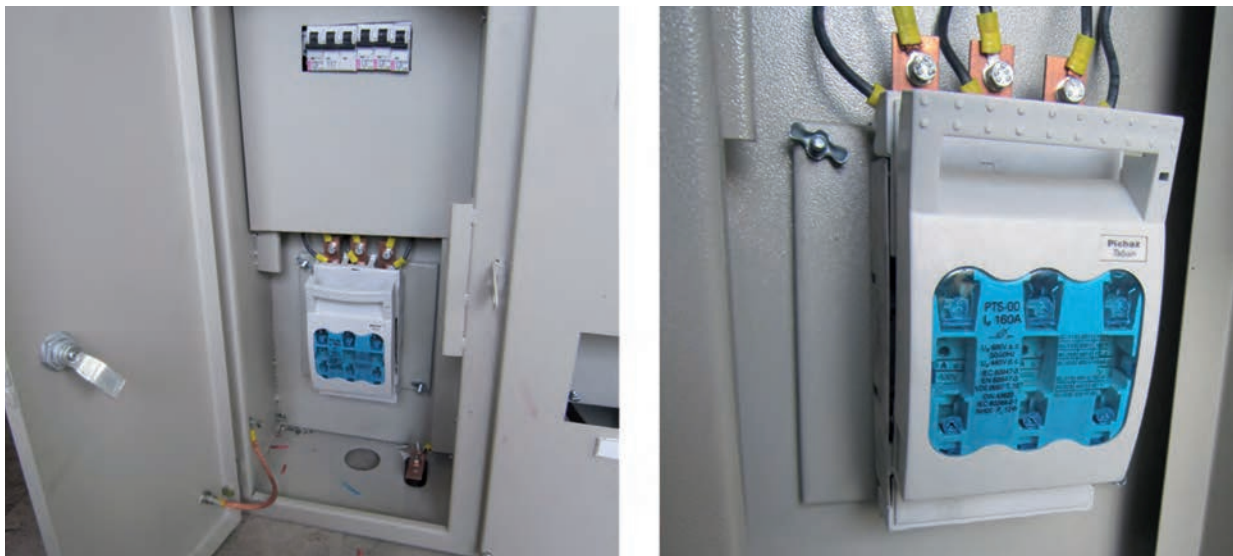
شکل ۲۳-۳- محل ورود کابل اصلی به داخل تابلو
