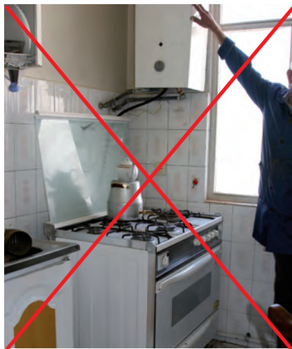
شکل ۱-۶ نصب نادرست آب گرم کن.
