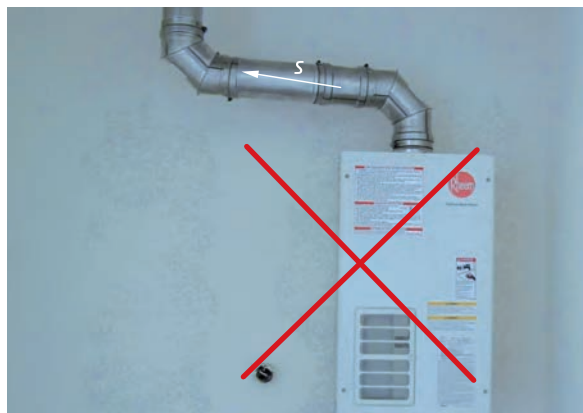
شکل ۱-۳۶ اتصال نادرست دودکش
