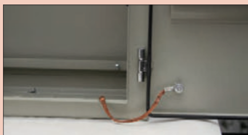
شکل ۸۵ - تسمه بافته مسی در تابلو
