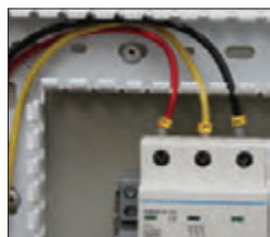
نصب غلط شماره سیم
