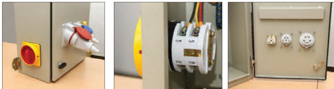
الف) نمای پشتی پریزهای نصب شده روی در تابلو و نمای پشتی پریز سه فاز ب) نمای کلید گردان و پریزهای نصب شده روی بدنه تابلو
