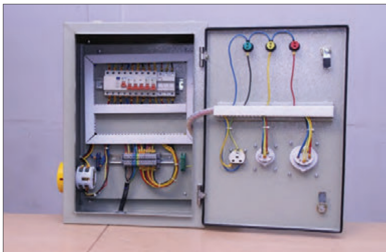
شکل ۵۸- نمای مختلف تابلو توزیع کارگاهی
