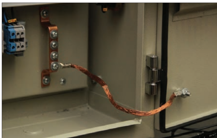
شکل ۹۲- صفحه نصب در داخل تابلو
