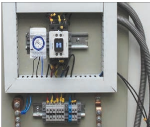
شکل ۱۰۷- محل نصب تایمر ۲۴ ساعت در تابلو روشنایی
