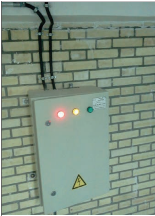
شکل ۲۰- مسیر ورود و خروج کابل‌ها در تابلو
