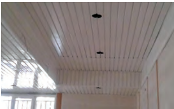
شکل ۳-۳- سقف کاذب فلزی
