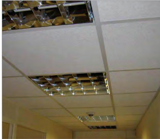
شکل ۱۳۰-۳- نصب اشتباه چراغ‌های مهتابی که سبب خیز برداشتن سقف کاذب مشبک شده است.
