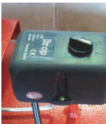
شکل ۱۸۸- جعبه کلید قطع و وصل جریان برق
