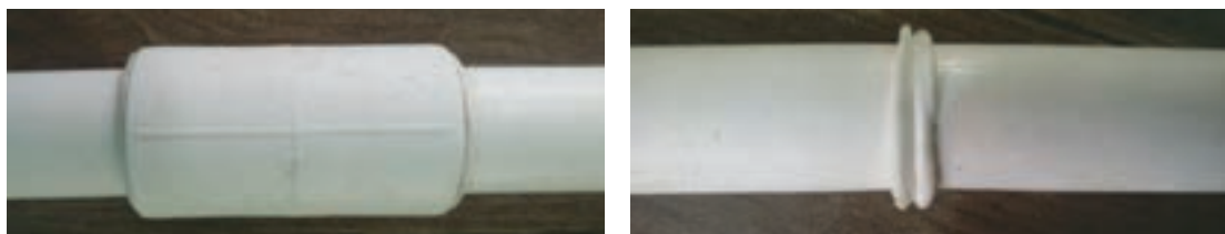
شکل ۲۱- سمت راست) جوشکاری لوله بدون بوشن - سمت چپ) جوشکاری لوله با استفاده از بوشن
