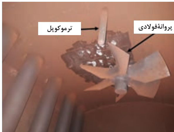
شکل ۱۴- فن گردش هوا در داخل کوره
