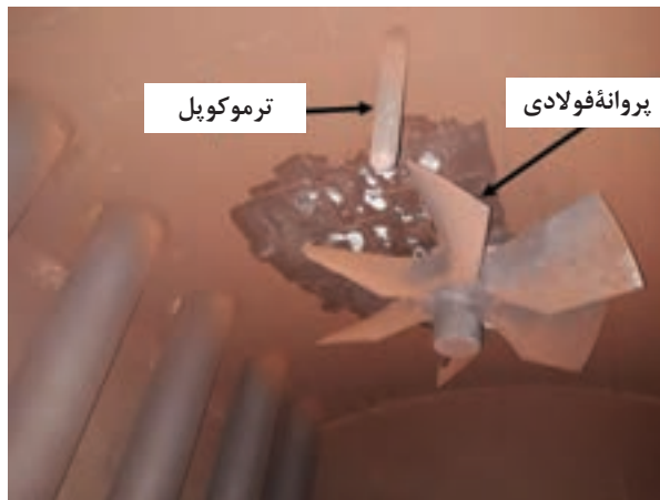
شکل ۱۴- فن گردش هوا در داخل کوره
