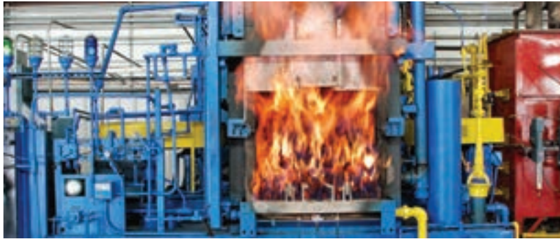
شکل ۵- کوره با اتمسفر کنترل شده
