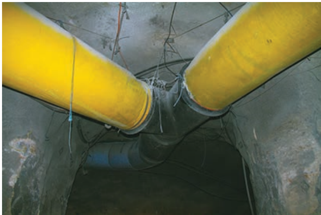
کانال‌های فلزی و برزنتی انتقال هوای معدن
