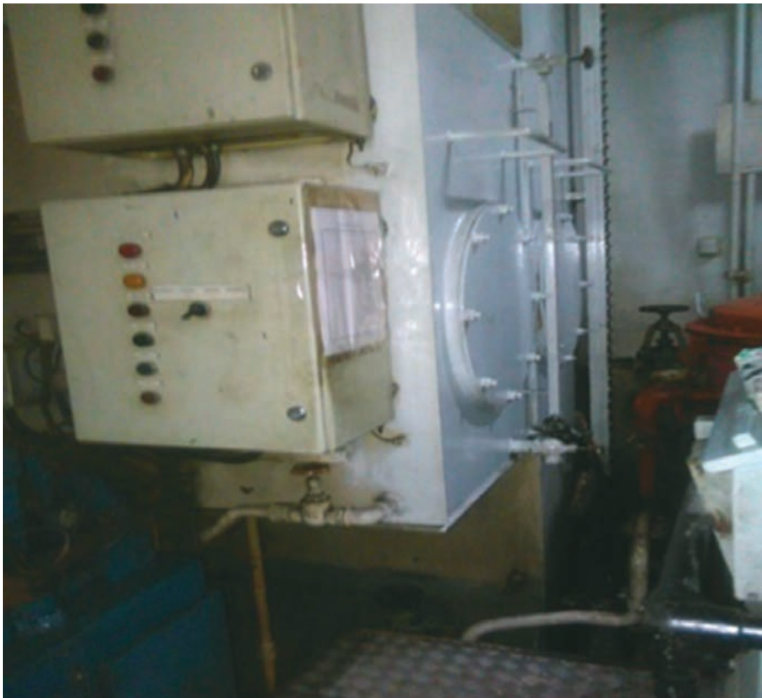
شکل ۲۳- مخزن سوخت روزانه یک شناور
