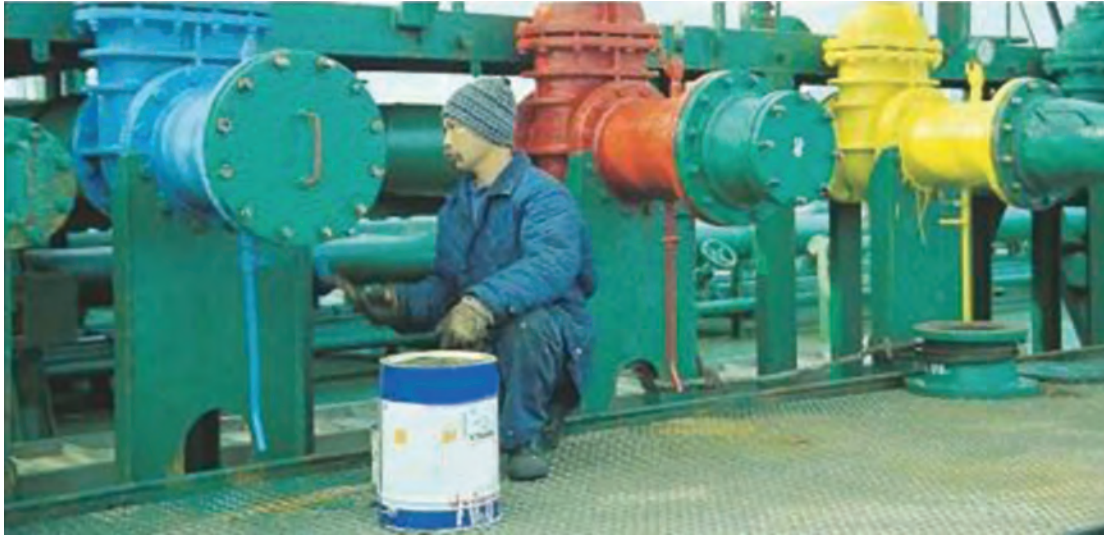
شکل ۵۵- رنگ آمیزی سامانه‌های لوله‌کشی بر روی عرشه
