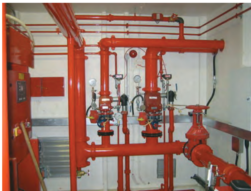
شکل ۱۰- قسمتی از سامانه آتش‌نشانی یک شناور
