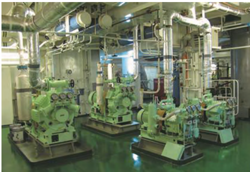
شکل ۱۹- کمپرسورهای هوا در ساختمان کشتی
