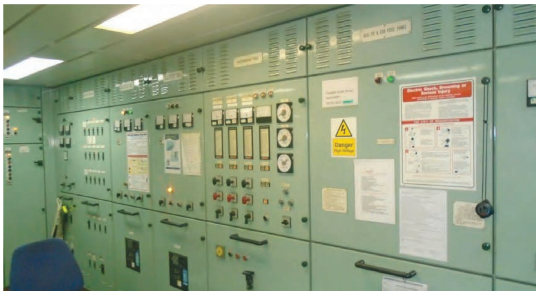
شکل ۲۳- تابلوی اصلی برق شناور
