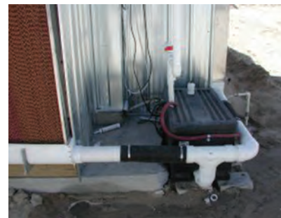
تصویر ۱۲-۲- پمپ و لوله های توزیع آب
