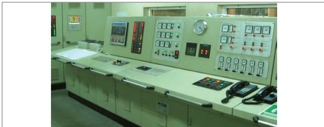
شکل ۴۰ - سامانه هشدار اتاق کنترل موتورخانه
