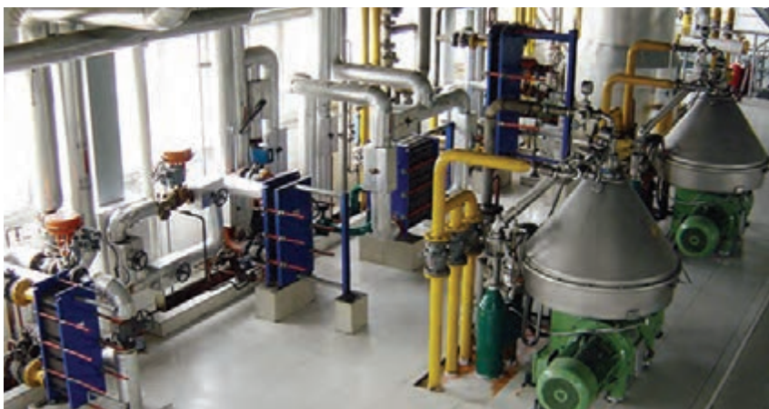
شکل ۶- سیستم خنثی‌سازی مداوم روغن
