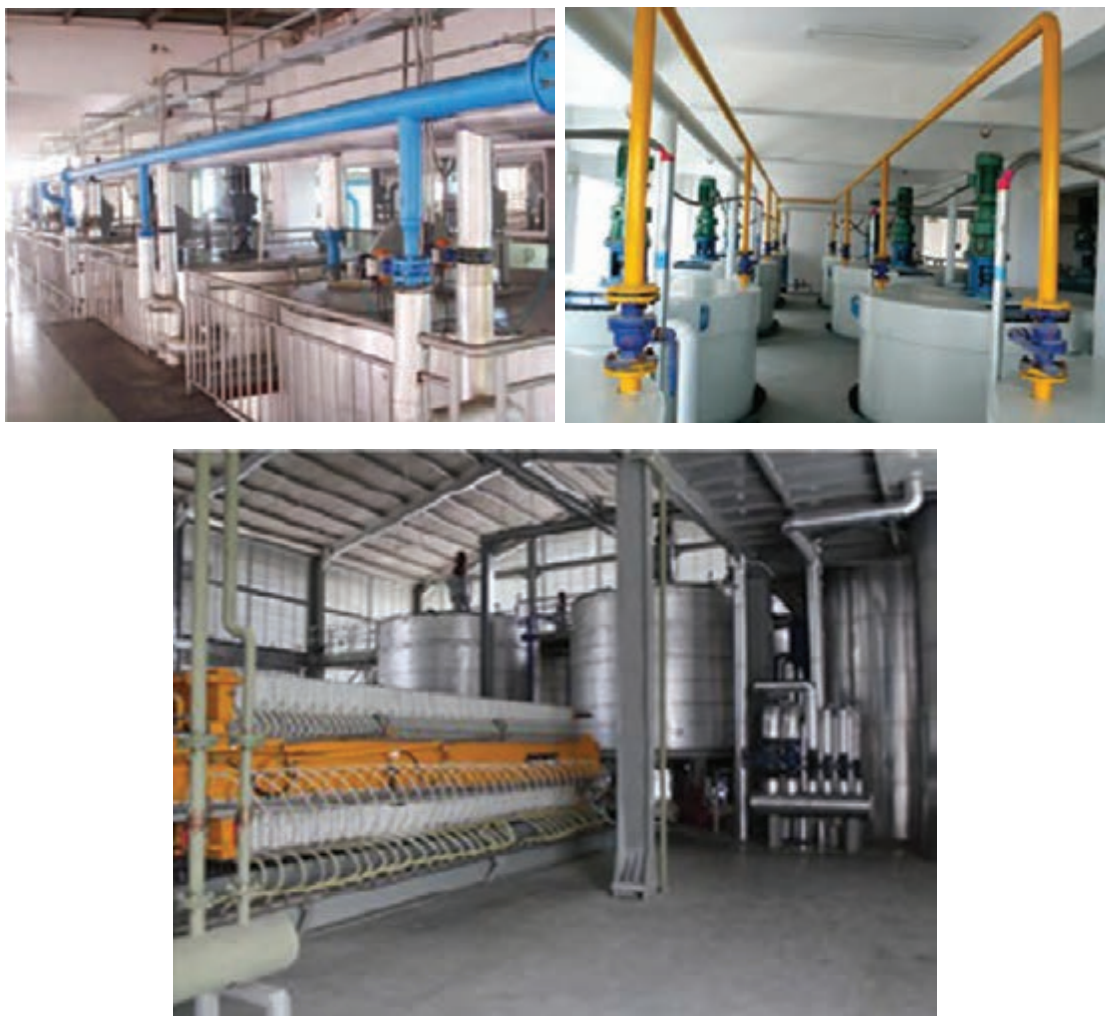
شکل ۱۰- سیستم تجهیزات جزء به جزء کردن روغن
