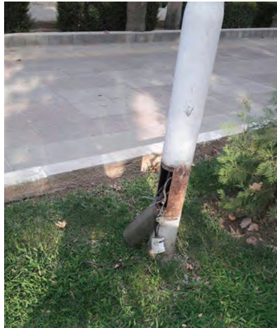
شکل ۲- وجود خرابی در سیستم برق کشی
