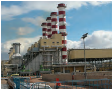
نیروگاه سیکل ترکیبی قم
