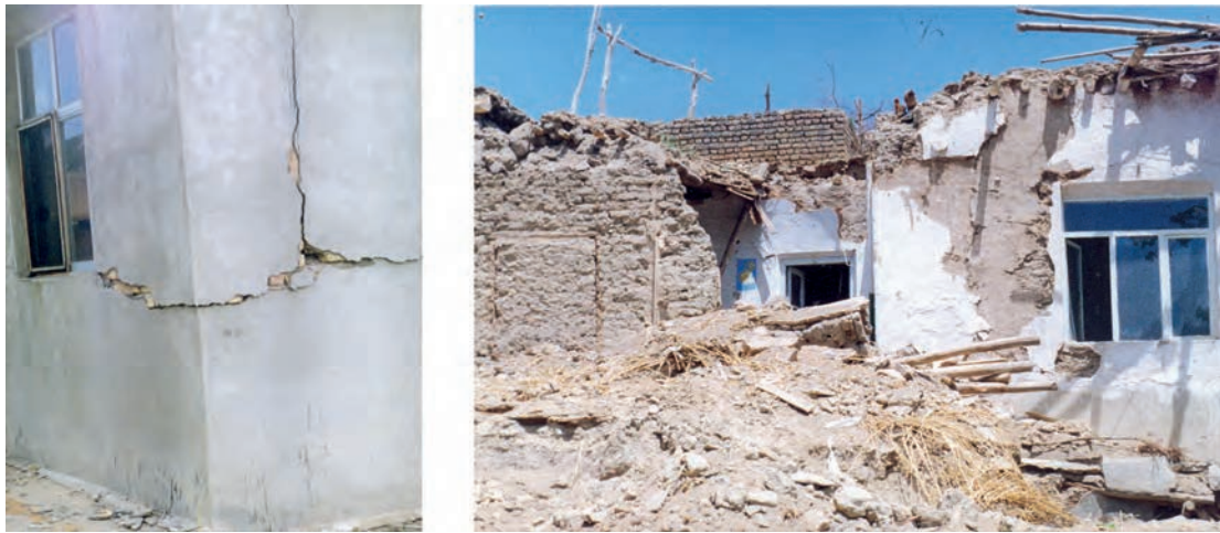
شکل ۳۶-۱- تصاویری از خسارت زلزله اردیبهشت ۱۳۸۱ در دینور
