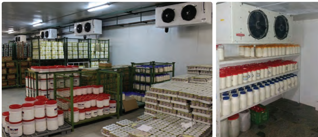
شکل ۱-۲-۱۰- سردخانه نگهداری ماست
