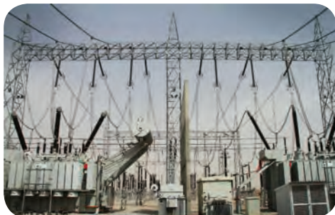
شکل ۱۷- پست انتقال برق
