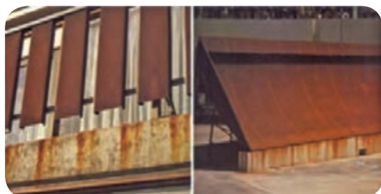
سطح زنگ زده ورق های آهنی در اثر قرارگرفتن در شرایط اتمسفر مرطوب
