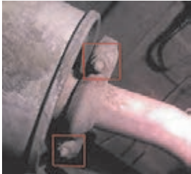
کنترل اتصالات لوله از صدا خفه کن
