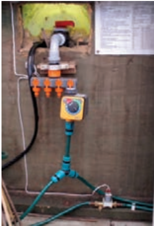
بخشی از سیستم آبیاری اتوماتیک
