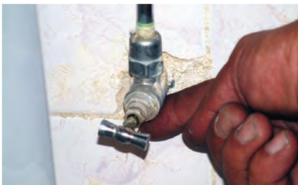
شکل ۱۴۷-۲- کنترل نشت آب از محل اتصال
