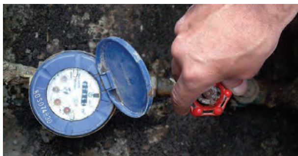
شکل ۱۴۰-۲ بستن شیر فلکه‌ی اصلی
