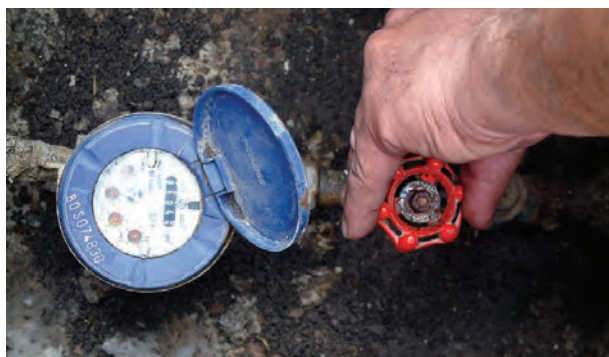
شکل ۱۹۷-۲- بستن شیر فلکه‌ی اصلی
