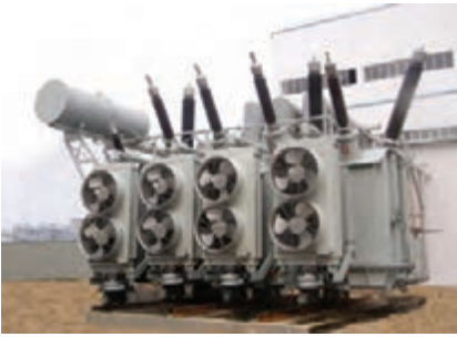
شکل (۳-۱) ترانسفورماتور خطوط انتقال
