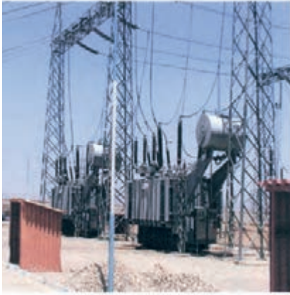
شکل (۳-۲۸) دو ترانسفورماتور موازی شده
